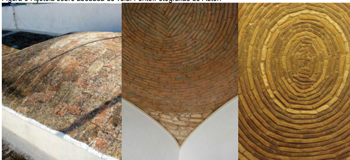
Figura 5-Açoteia sobre abóbada de vela. Fonte:Fotografias do Autor.
